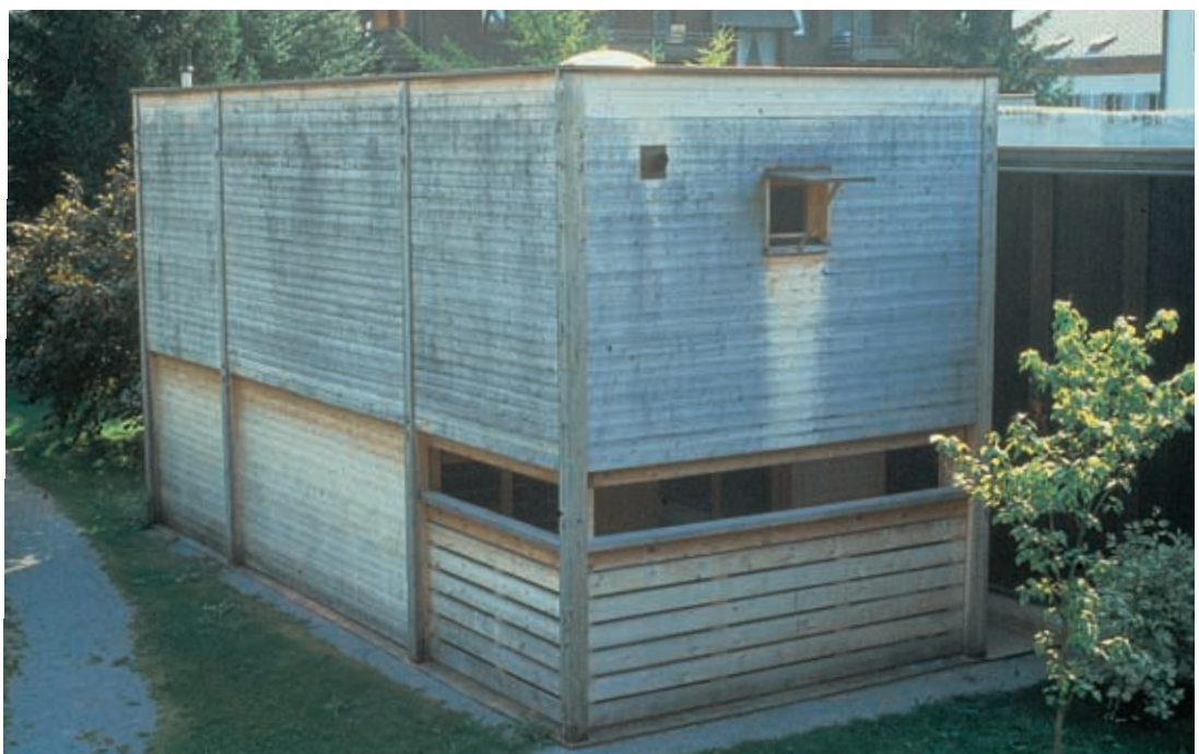
Bild 4 Deutlich ungleichmässige Verwitterung und Vergrauung einer Fassade. Der Witterungsschutz durch kleine Dachvorsprünge und Fenstersimsen ist nur sehr lokal wirksam.
