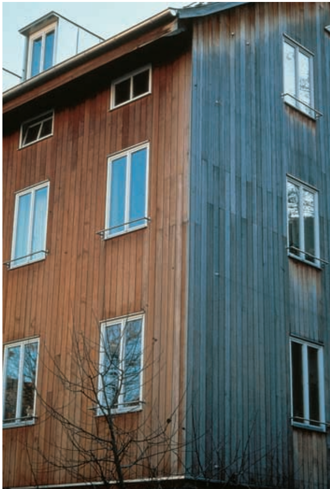
Bild 6 Deutlich unterschiedliche Verfärbung einer Wohnhausfassade in Abhängigkeit von der Himmelsrichtung. Westfassaden vergrauen wegen Regenbeanspruchung meist stark, Südfassaden bleiben trockener und vergrauen weniger, Nord- und Ostfassaden oft gar nicht.
