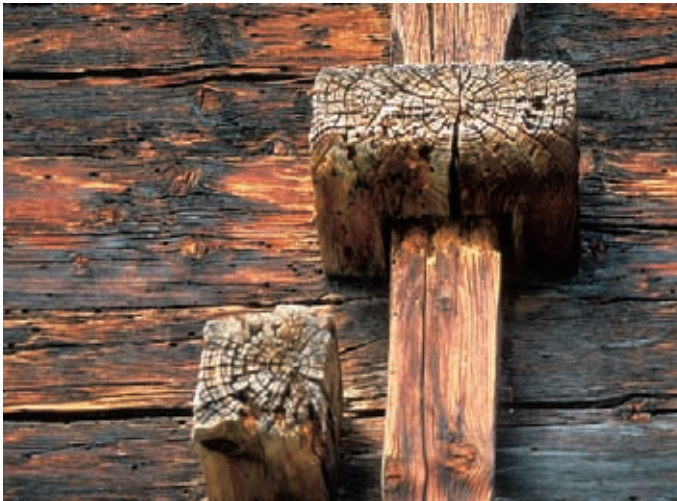
Bild 3 Kräftig braune bis schwarze Holzverfärbung der Südfassade eines Walliser Wohnhauses aus Fichtenholz. Infolge des sehr trockenen Klimas und des grossen Vordaches ist die Fassade nicht von Vergrauungspilzen besiedelt.
